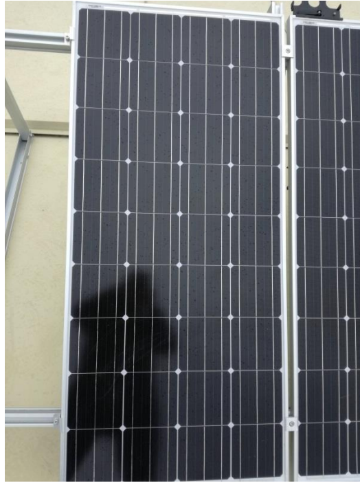
Figura 72: Fotografía 7° Medición - Paneles FV Sucio
