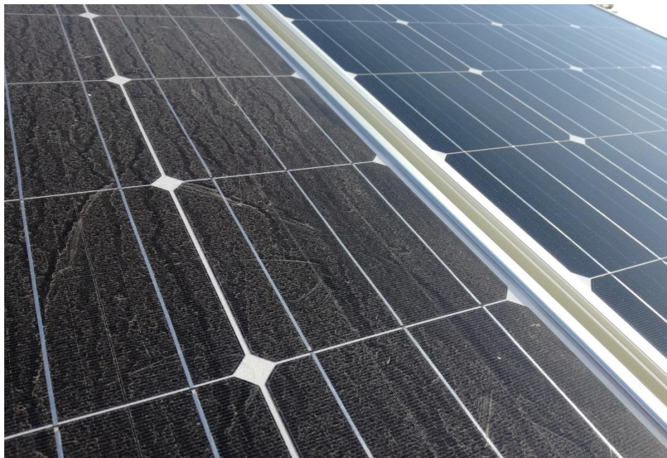
Figura 96: Fotografía (1) 21° Medición - Panel FV Sucio (izq) y Limpio (der)
