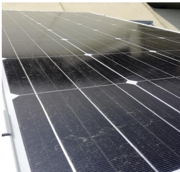
Figura 70: Fotografía 6° Medición - Paneles FV Sucio
